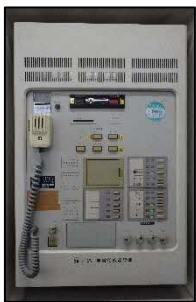
非常放送用設備
